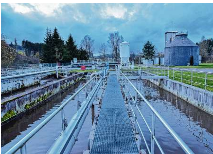
Auch die Kläranlage in Peterzell ist in die Jahre gekommen und bedarf einiger Sanierungsarbeiten, die in den nächsten zehn Jahren erledigt werden müssen. BILD: ROLAND SPRICH
